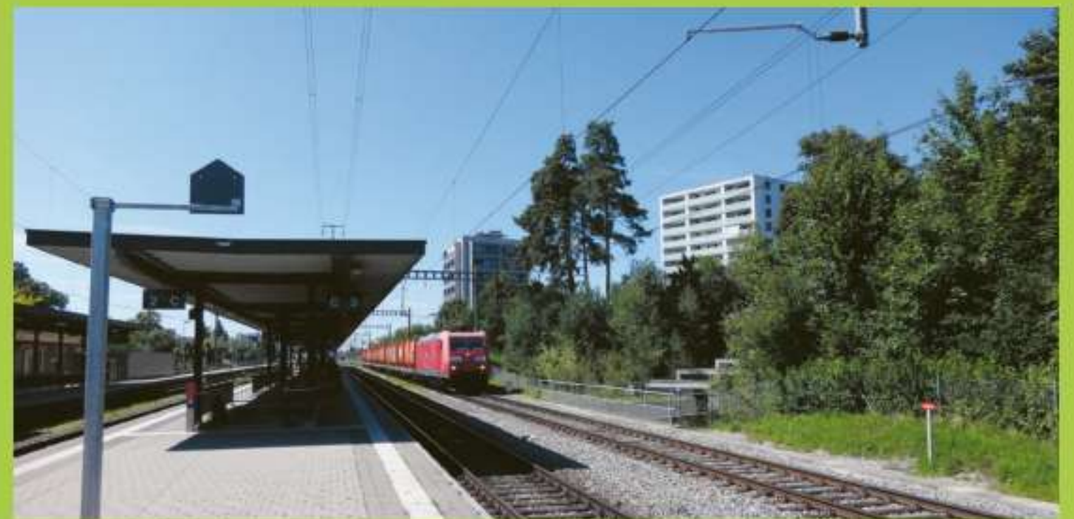
Das Gleis 4 im Bahnhof Kreuzlingen wird zu einem vollständigen Perron ausgebaut. Momentan steht dort ein Zug, der Kehrlicht aus dem Landkreis Konstanz in die KVA Weinfelden transportierte.
