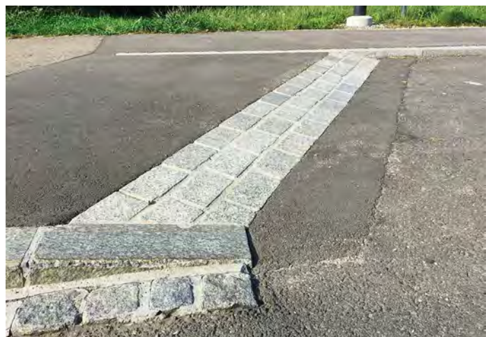
Schon bald Vergangenheit: die Holperkante an der Gäustrasse in Hägendorf.
